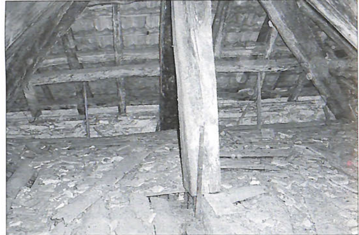
Il soffitto come si presentava prima dei lavori.
